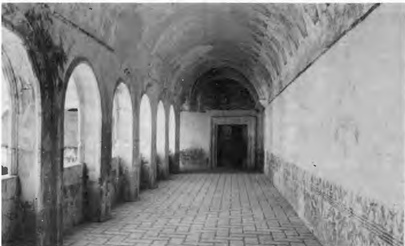
laustro alto, vista de un corredor e intradós de las bóvedas. Foto Juan B. Artigas. 1989.
